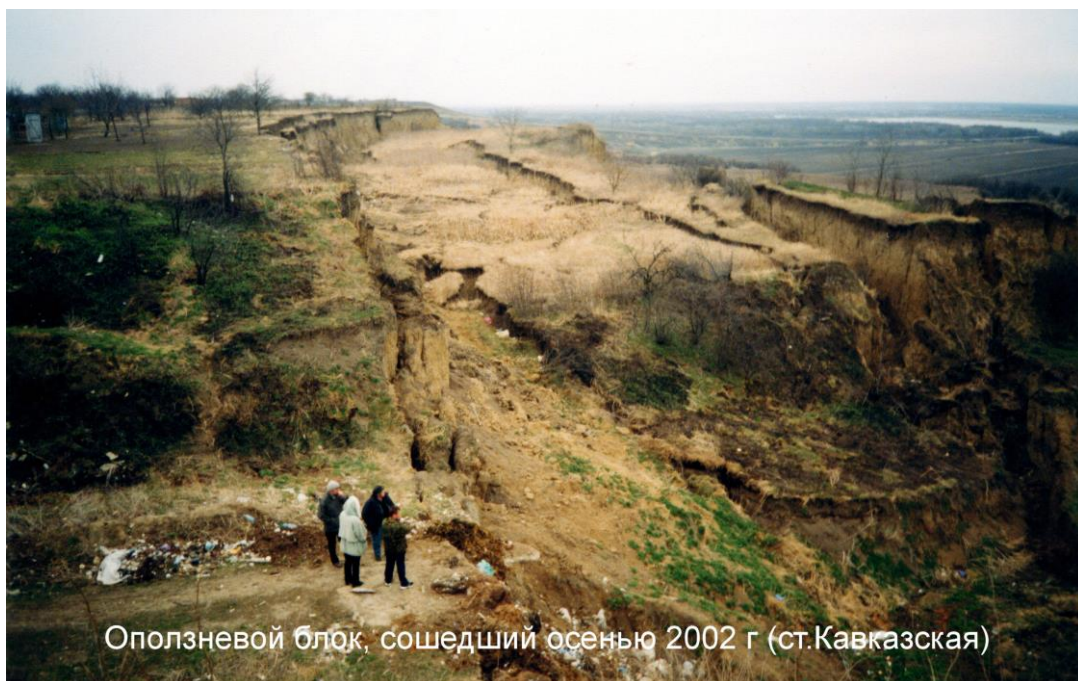
Рисунок 15 – Трещины в предоползневом состоянии. Начало
